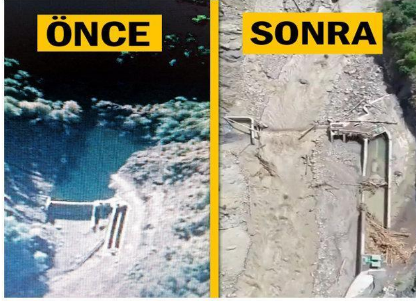
Görsel 7. Bozkurt'taki Hidroelektrik Santrali'nin sel afetinden önceki ve sonraki görüntüleri
